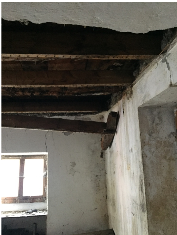
Foto 1 soffitto con malta mista a gesso, già parzialmente caduto
