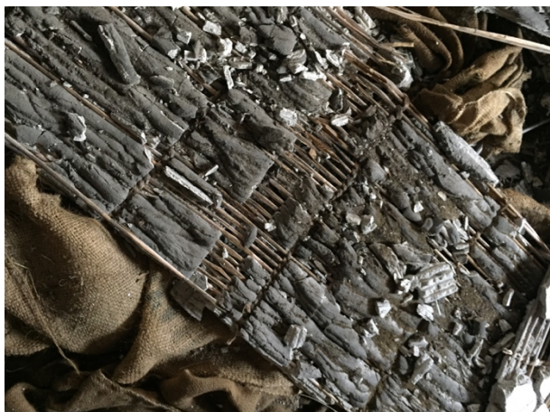
Foto 3 struttura di soffitto composta da cannuce e intonaco che, per una facile lavorazione, conteneva del gesso. Ora caduta
