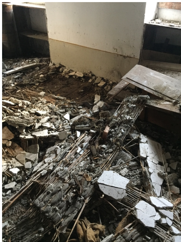
Foto 4 soffitto caduto. Il ripristino non è più possibile
