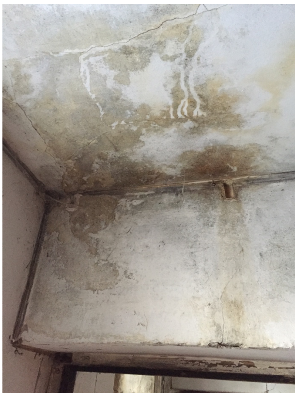
Foto 5 infiltrazioni di umidità hanno causato macchie e scrostamenti degli intonaci. Si osservino le fessurazioni fini che con il perdurare del fenomeno, si allargheranno ulteriormente
