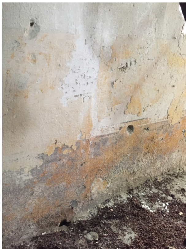
Foto 6 perdite dello strato di colore, scrostature e sollevamenti. Lacune e fessurazioni di intonaco
