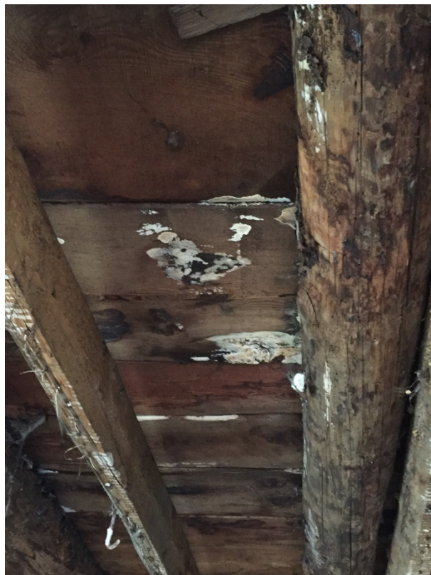
Foto 2 zone con umidità e funghi si presentano sotto forma di macchie chiare e aloni
